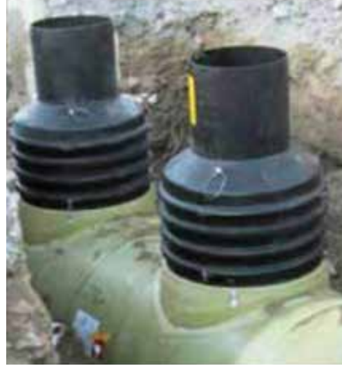
Şekil 6: EuroHUK 600 muayene bacası uygulaması
